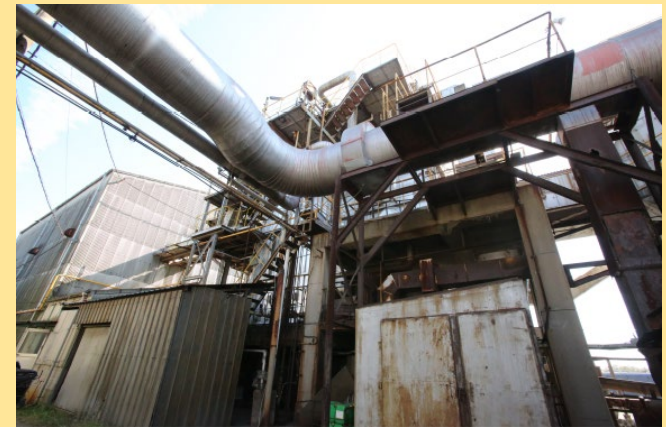
バイオマスボイラー（昭和62年導入）
